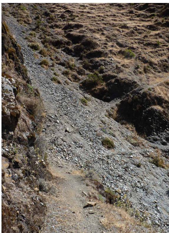
Foto 20. El camino ha sufrido los efectos de la erosión y la falta de mantenimiento. En lugares críticos como las quebradas, el camino está prácticamente borrado
