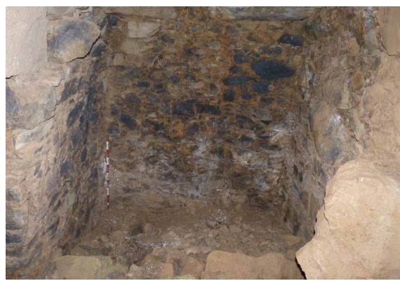
Foto 16. Paramento interno del cuarto o cámara principal del mausoleo. Pueden apreciarse las huellas de las quemaduras producidas posiblemente en el marco de las extirpaciones de idolatrías
